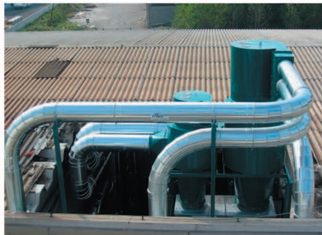
Vista dei gruppi di separazione della linea scatolificio e della linea ondulator presso la Mauro Benedetti di Perugia.
