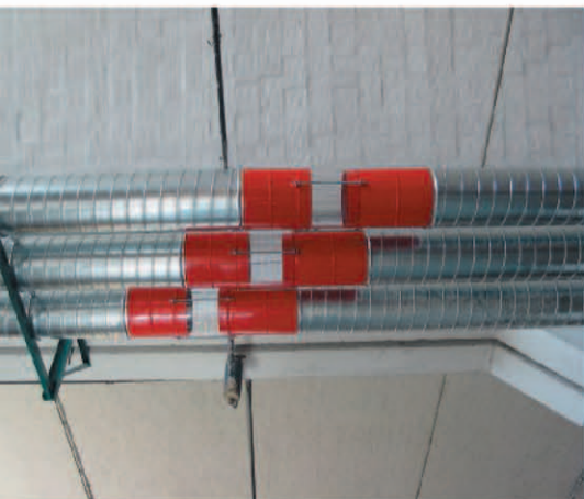
Linee di aspirazione con ispezioni visive trasparenti presso l'impianto perugino di Mauro Benedetti.
