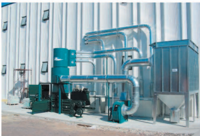
La parte esterna di un impianto a servizio di uno stabilimento di arti grafiche: a destra il filtro e a sinistra la pressa di imballaggio.
