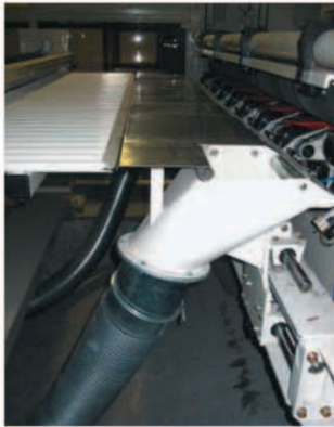
Bocchette di aspirazione per ondulatore presso la Mauro Benedetti.
